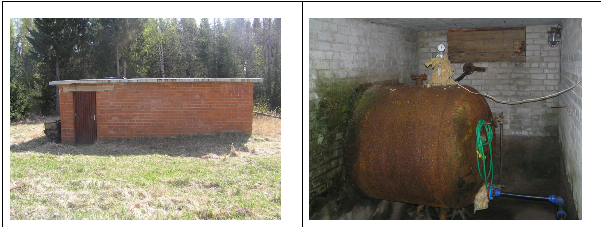
Joonis 6. Soodoma küla puurkaevpumpla välis- ja sisevaade.
