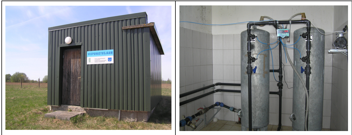
Joonis 7. Hurmi küla puurkaevpumpla välis- ja sisevaade.
