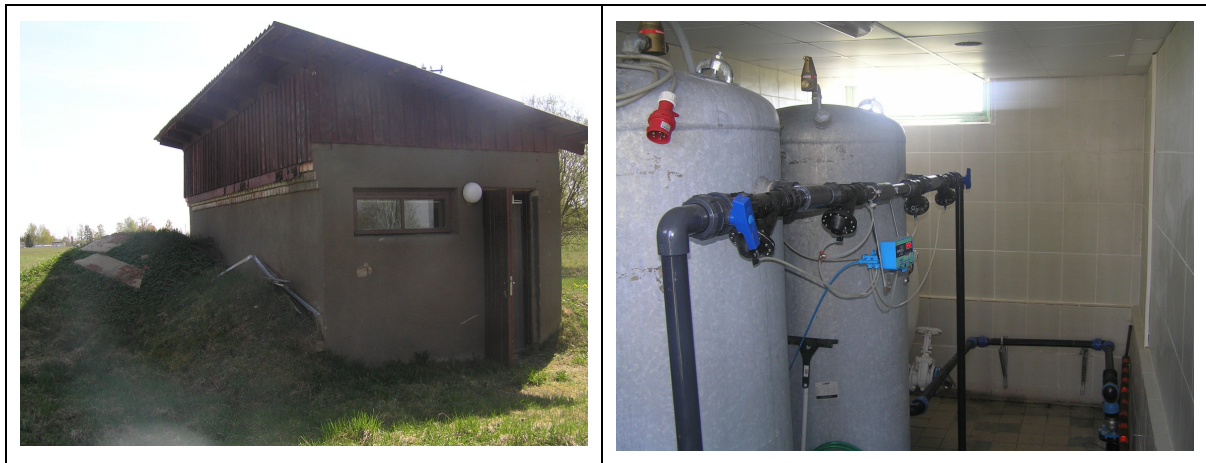
Joonis 5. Põlgaste küla puurkaevpumpla välis- ja sisevaade.
